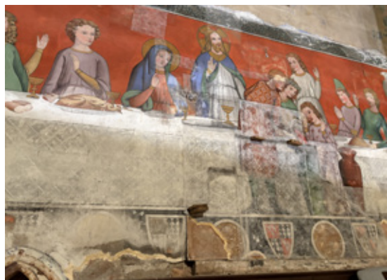
Une des peintures en très mauvais état située dans le chœur de l'église.
